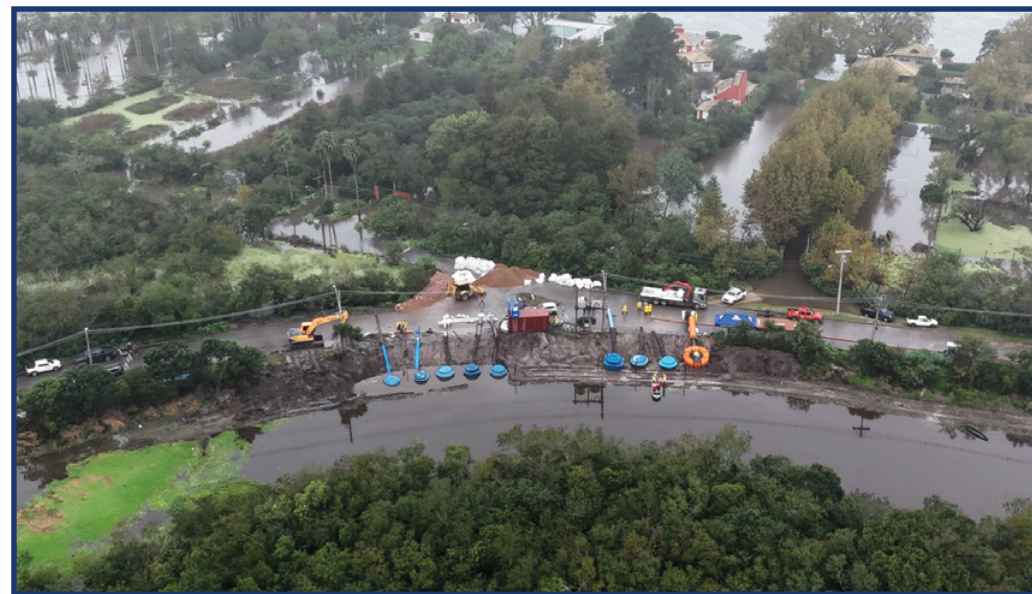
Bombas instaladas na Estrada do Engenho
