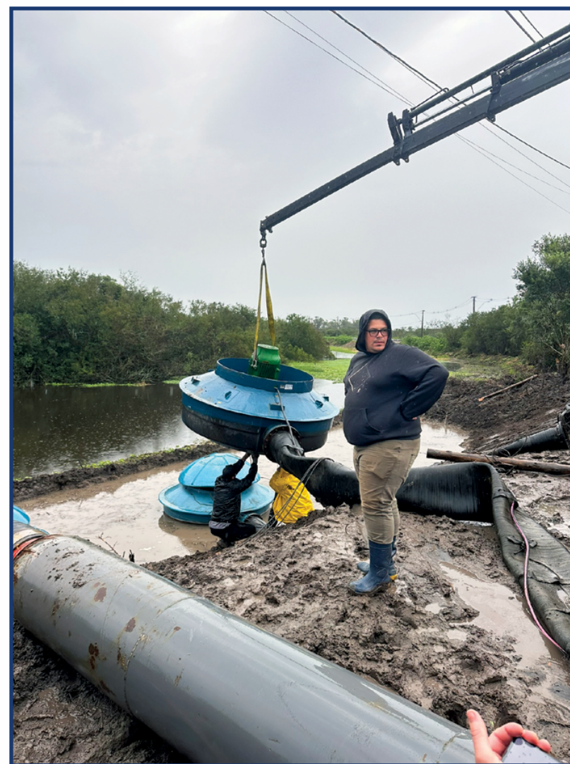
Sistema de bombas flutuantes instalado na Estrada do Engenho, em Pelotas
