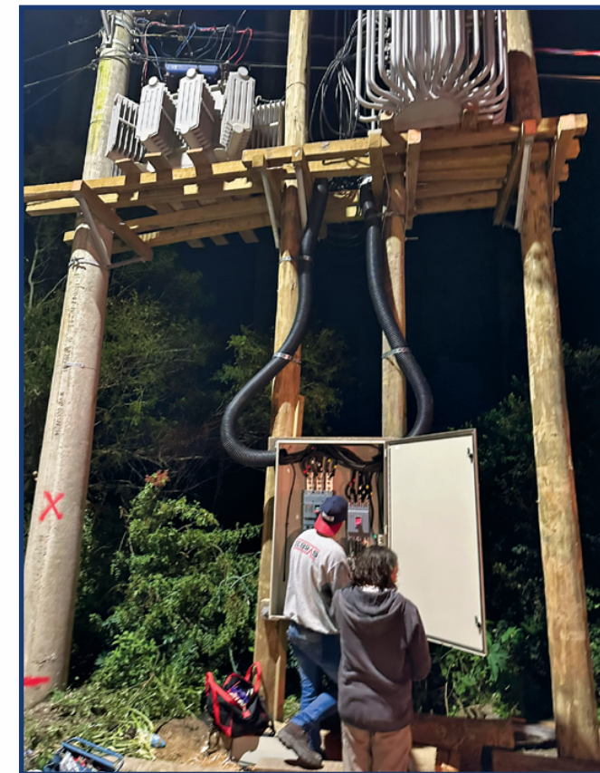
Transformadores instalados na Estrada do Engenho para alimentar as bombas de drenagem
