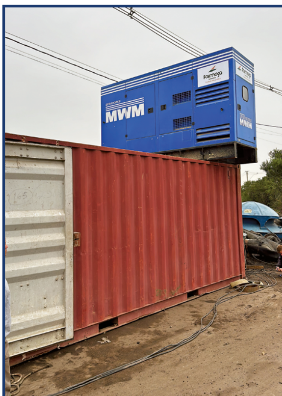
Gerador foi colocado sobre contêineres para evitar que ficassem submersos, em caso de alagamento na região
